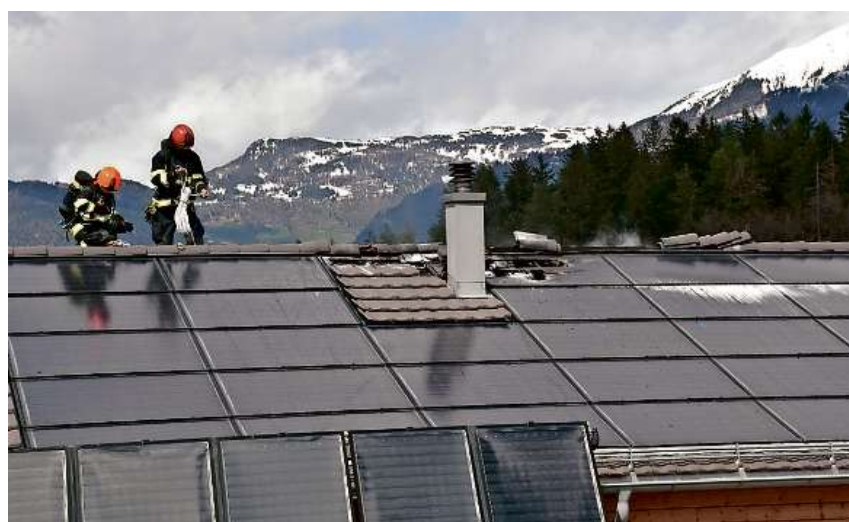
Dachbrand wegen überhitzter Solaranlage, das muss nicht sein. Die richtigen Vorkehrungen verhindern oder vermeiden Schäden. Bild Kapo Graubünden
