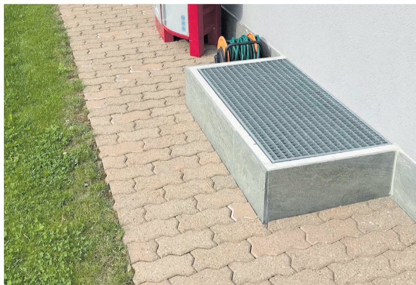
Auch einfache Massnahmen - wie das Erhöhen von Lichtschächten - können Schäden verhindern. Bild zvg
