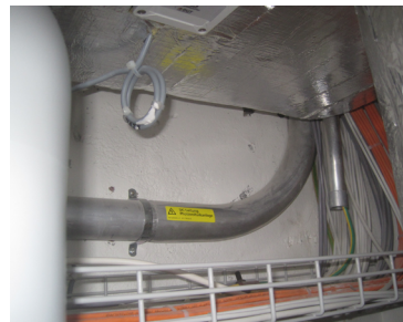
PV-Gleichstromleitung in komplett geschlossener Alu-Rohrleitung inkl. Kennzeichnung
